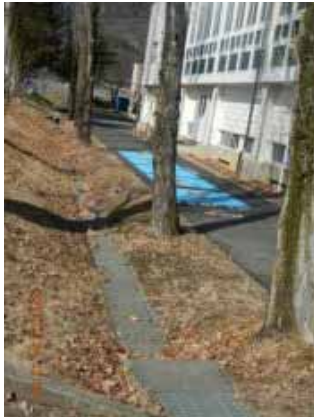
側溝のコンクリートのため、根がこれ以上張れず、木の倒れる危険が高くなりました
